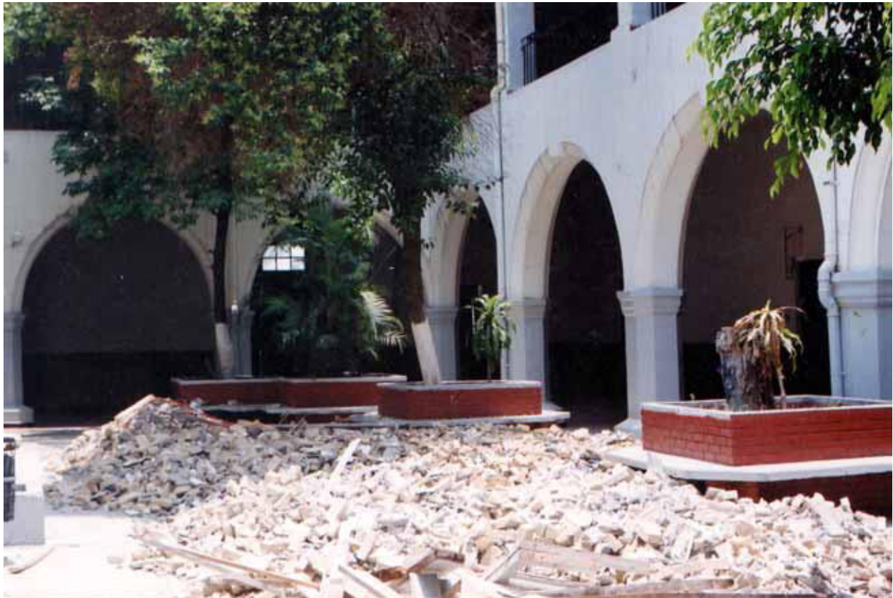
Dentro del proyecto se contemplaba eliminar las áreas llamadas “espurias”, elementos ajenos al edificio original.
