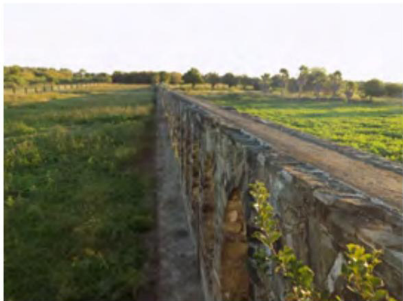
Figura 7. Vista actual de la atarjea de 217 m de longitud del acueducto. Nótese que en el sector de la arcada las paredes de la atarjea han sido totalmente destruidas.
