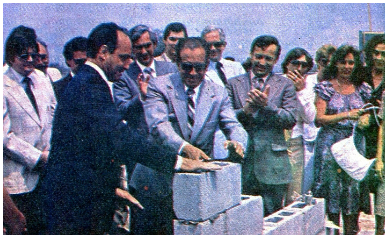
Colocación del primer cimiento de la Alianza Francesa de Monterrey en el municipio de San Pedro. En primer plano, el Embajador francés René Bernard con el Gobernador de Nuevo León, Alfonso Martínez Domínguez. 107
